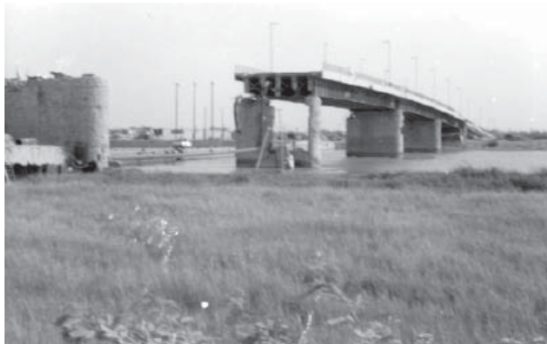
پل خرمشهر که در زمان اشغال این شهر به دست عراقی‌ها تخریب شد.
